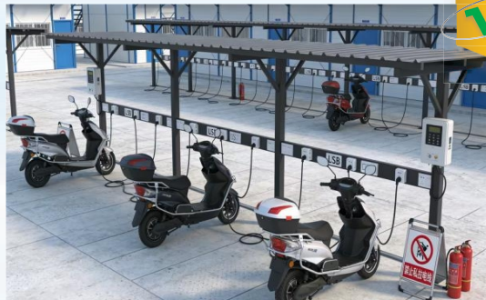
生活区电动车集中充电区
