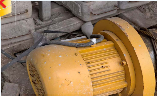
使用绝缘保护破损、外壳破损等“带病”用电设备
