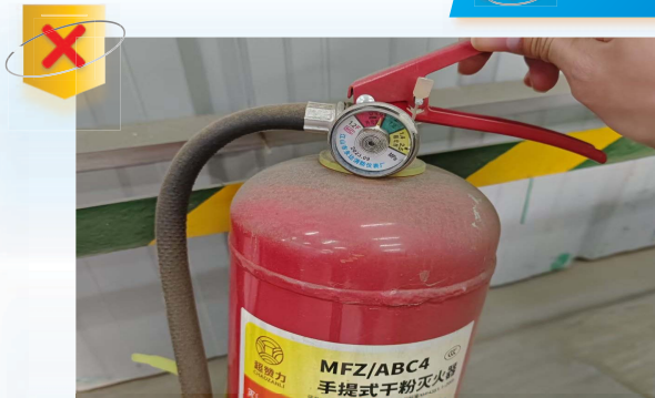
现场消防器材失效
