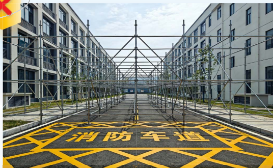
外脚手架占用疏散通道、安全出口、消防车道
