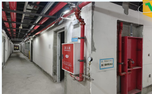
消防水接至作业楼层
