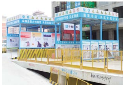
施工电梯入口处
