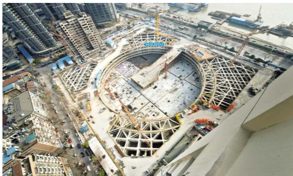
武汉长江航运中心工程深基坑大底板施工胜利全面闭合
