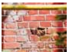
墙面风化、泛碱、剥落严重
