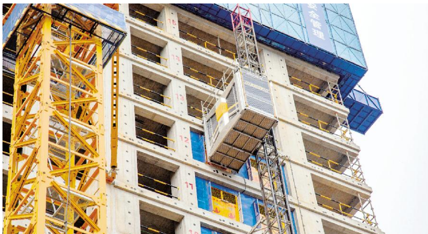
项目部应用智能升降机、塔机安全监测系统等智能化设备
